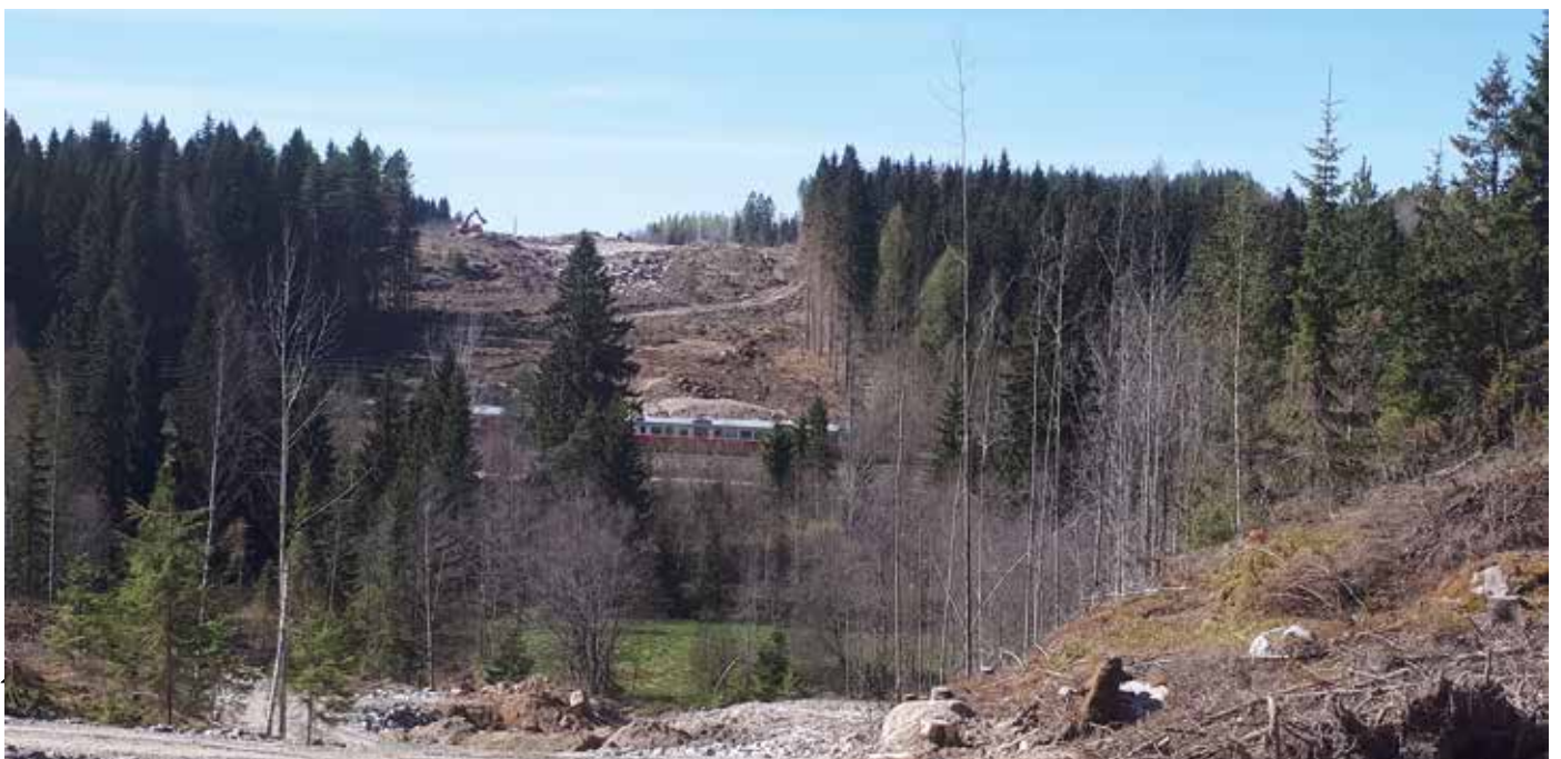
Toinen urakan laaksosilloista rakennetaan Vähäjoen ja Riihimäki – Kouvola –junaradan yli. Vähäjoen ylikulkusilta on liittopalkkirakenteinen silta jolle kertyy mittaa 230 metriä.
